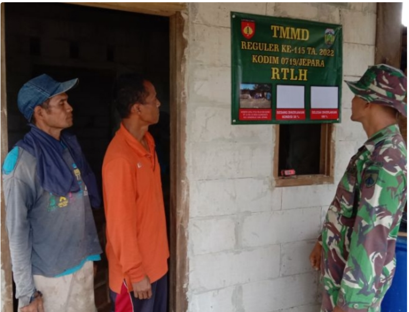
Tim Satgas TNI Manunggal Membangun Desa (TMMD) Reguler Ke-115 Kodim 0719/Jepara Proses Rehab Rumah Tidak Layak Huni (RTLH) Milik Ibu Kusni (75) di RT.04 RW.02 Dukuh Sidorejo.
